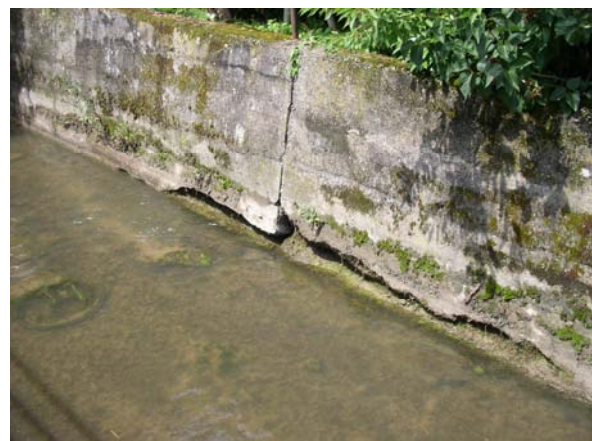
Bild 12: Blick auf Mauerschäden hier am Mühlkanal
